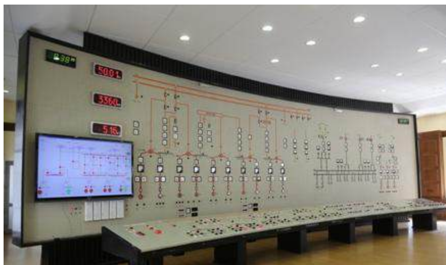
Рисунок 4. Центральный пульт управления
