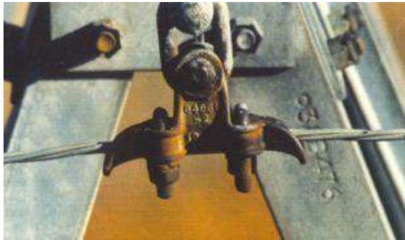
Рисунок 4 – Поддерживающий зажим со следами коррозии
