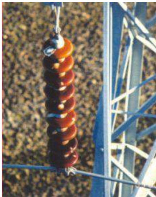
Рисунок 1 – Разрушение юбки изолятора дугой
